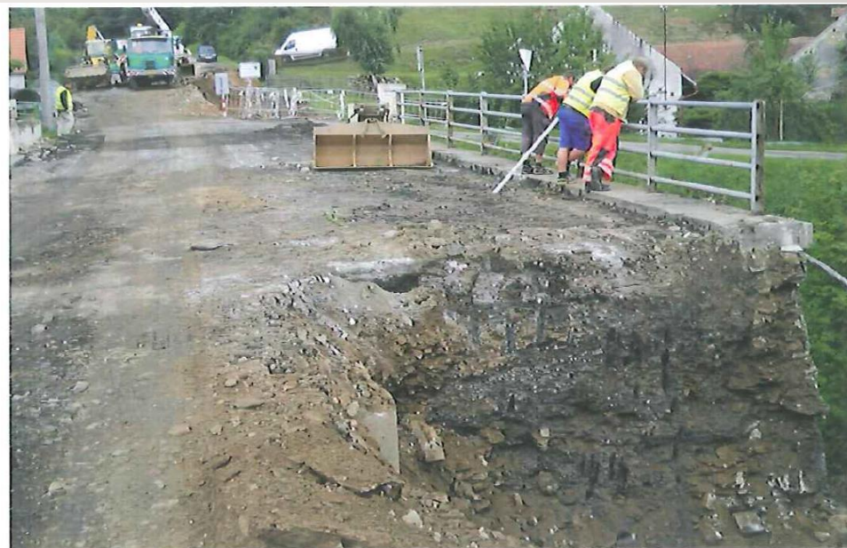
Foto 2 [14.8.2014 12_17 Krupička] Pohled po staničení; detailní pohled na škvárobetonové vrstvy po odtěžení pravé poloviny silničního tělesa za opěrou č. 1 dne 14.8.2014; foto pořízeno v čase 12:17
