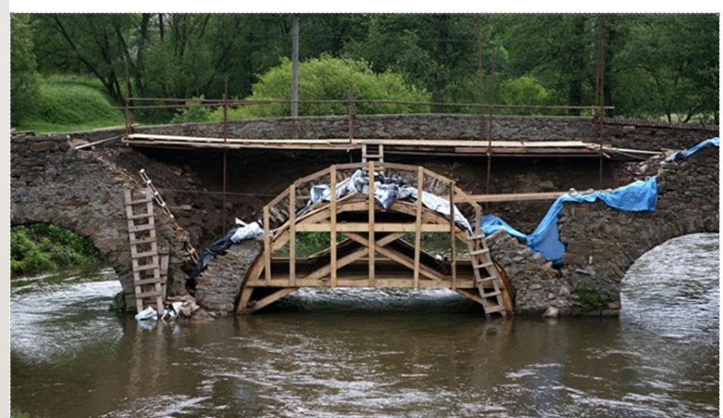
Obr. 11 – podpěrná skruž při rozebírání klenby mostu se zábradlím na ochranu pracovníků proti pádu
